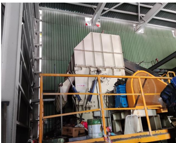
预处理车间破碎工序
