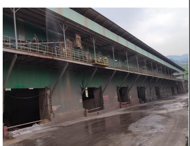
联合储库（一般固废暂存，洒水降尘）
